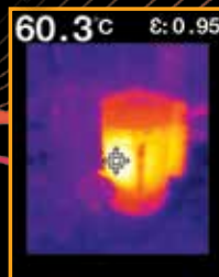
Перегрев механического оборудования
